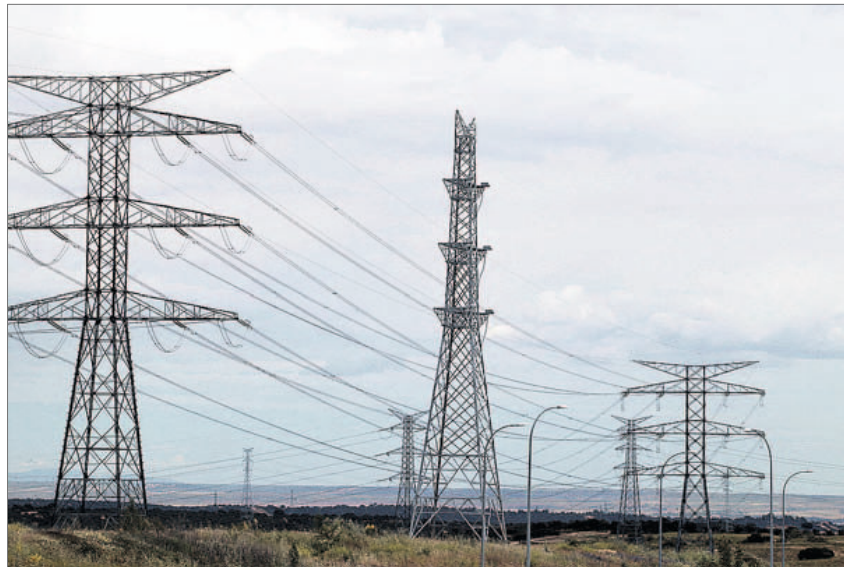
Torres de tendido eléctrico de alta tensión. PABLO MONGE
